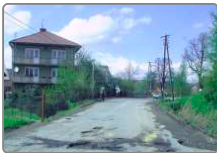
Zniszczona nawierzchnia asfaltowa w os. u Marka
