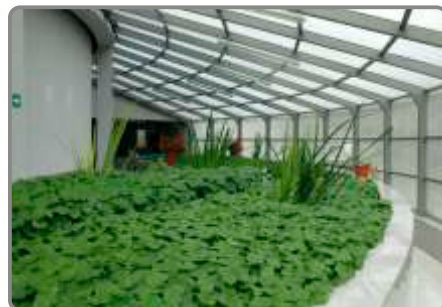
Wnętrze oczyszczalni ścieków
