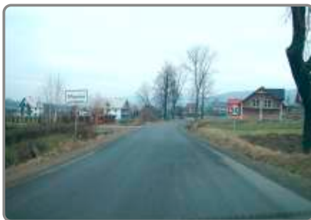
Stan drogi powiatowej po pierwszym remoncie
