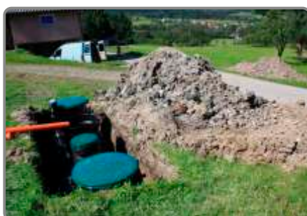
Przydomowa oczyszczalnia ścieków
